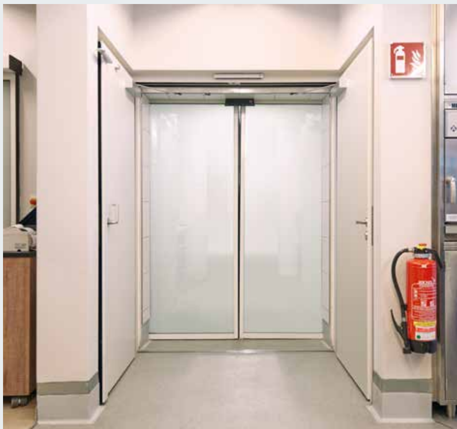
Внешний вид огнестойкой и дымонепроницаемой двери (эксплуатация в дневное время)
